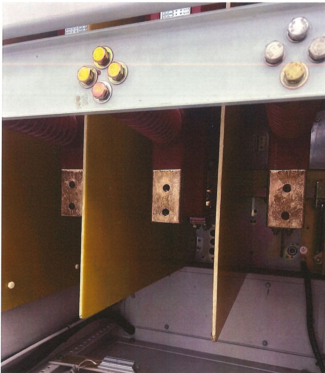
圖 3 高壓配電盤負載側接點
